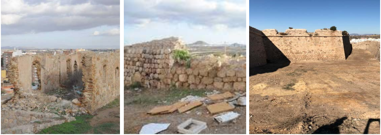
Figure 17. Estado de conservación del castillo de Los Moros
