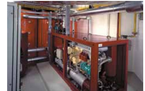
50 elektriske kW motor administreret af sociale boligselskabers forening Rödelheim, Frankfurt, Tyskland.
