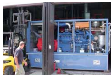
CHP motor 611 elektriske kW, 800 termal kW effekt gasmotor for distrikts varmenetværk, Sossenheim, Frankfurt, Tyskland.
