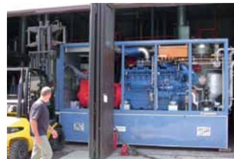
Moteur électrique PCCE de 611 kW, moteur thermique à gaz de 800 kW pour le réseau de chauffage collectif de Sossenheim (Francfort, Allemagne)
