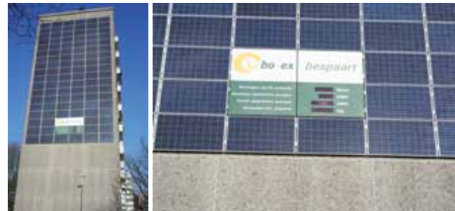
Chauffe-eau solaire (Utrecht, Pays-Bas)
