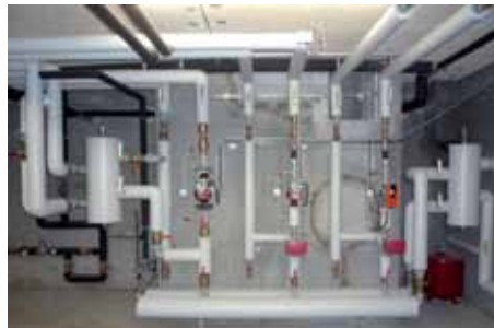
Sous-station de chauffage urbain (Grenoble, France)
