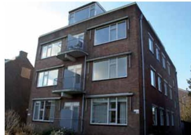
Rénovation de logements sociaux avec PCCE de petites dimensions, Tuinwijk, Utrecht, Pays-Bas
