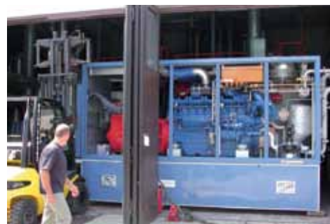
Gasgestookte WKK-generator 611 kW elektrisch, 800 kW thermisch voor stadsverwarming, Sossenheim, Frankfurt, Duitsland
