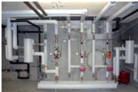
Onderstation stadsverwarming, Grenoble, Frankrijk
